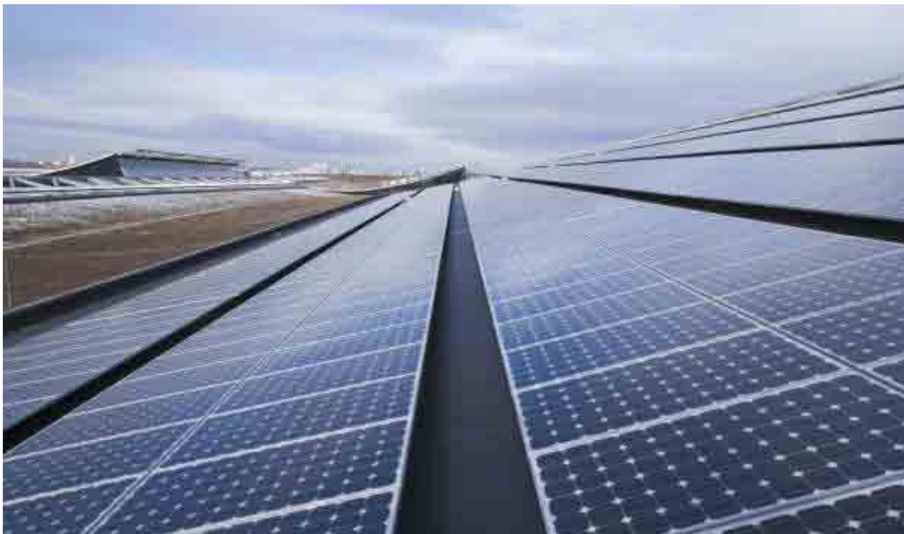
Nuevo Recinto Ferial de Stuttgart: uno de los mayores sistemas fotovoltaicos del mundo.
